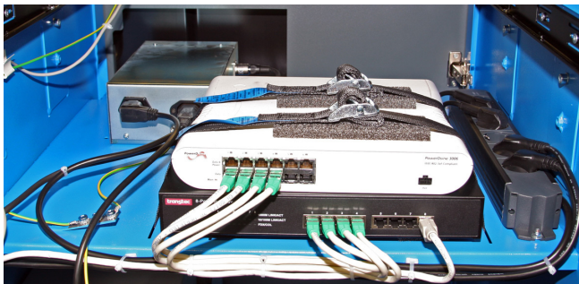
Fig. 1: Conexión de los cables LAN
